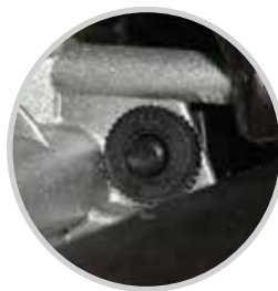
BREAKER DE SEGURIDAD
